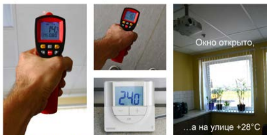
Эффект от функционирования потолочных панелей охлаждения Upronor в теплое время года. Административный корпус завода Upronor в Ленинградской области.
